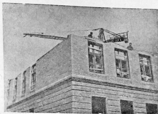
В городе Ворошилове, на улице Агеева, идет строительство многоэтажного здания новой средней школы. На снимке: на строительстве школы.
